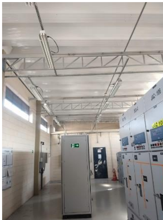
Figura 3 - Sala de Painéis.
